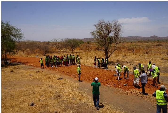
Aménagement de la piste sur l'axe Abkhousoun-Kerfi. Photo. M. Ngodro. APLFT. Avril 2021. Province du Sila
