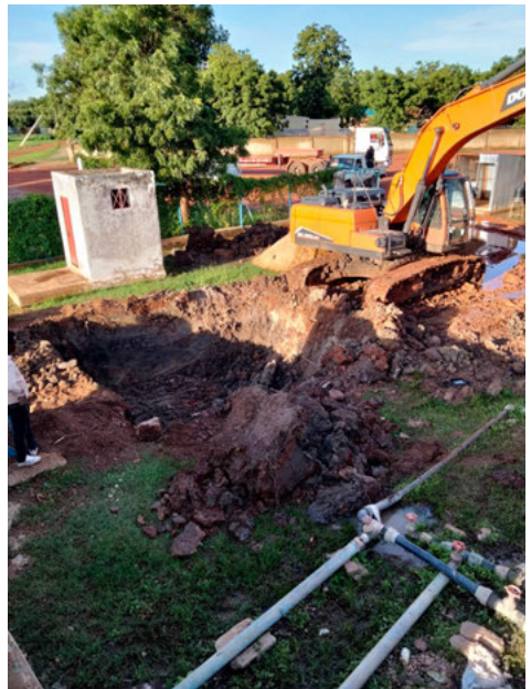
Excavation pour la fondation d'un réservoir en acier pressé dans la station de traitement des eaux de Bentiu, comté de Rubkona, juillet 2022. Photo : Stephen Waswa Otieno / Concern Worldwide.
